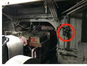
Çimento Fab. Değirmen Motor + Redüktör
