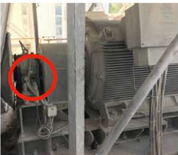
Çimento Fab. Fan Motoru
