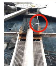
Soğutma Kulesi Motor + Redüktör
